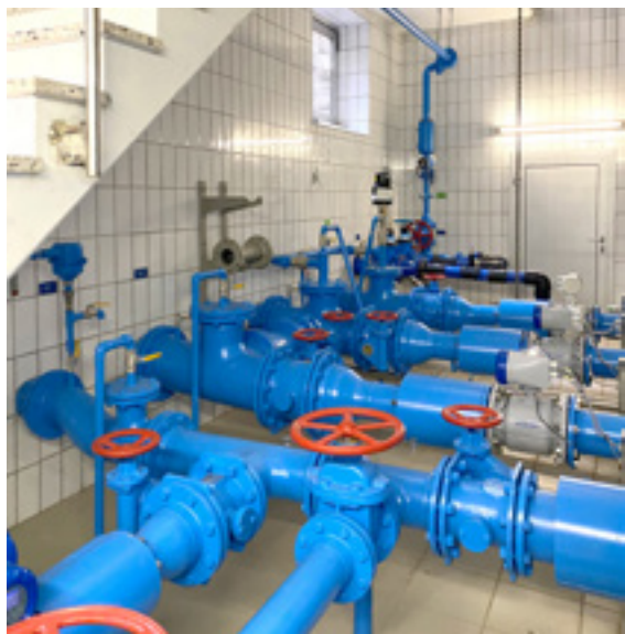
Rohrkeller Hochbehälter Bergwald
