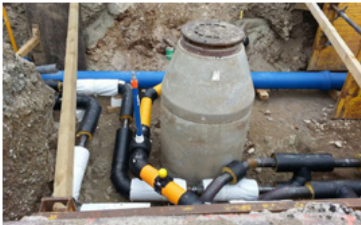
Behebung von Leckstellen innerhalb der Gemeinde
