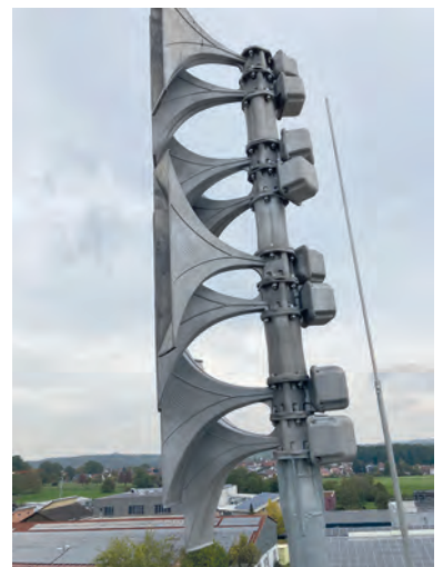
Sirenen in auf dem Feuerwehrhaus in Straubenhardt.
